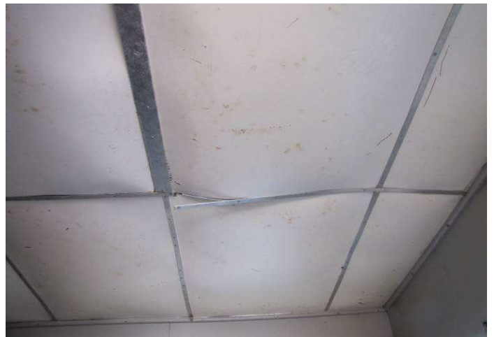
zdeformowane płyta sufitowa wnętrza skrzyni ładunkowej
