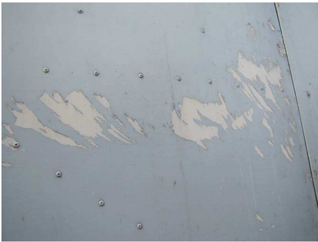
ubytki powłoki lakierniczej oblachowania skrzyni ładunkowej
