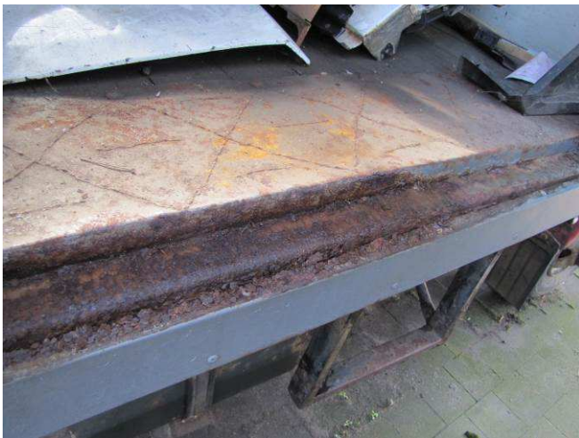
skorodowana płyta podłogowa skrzyni ładunkowej
